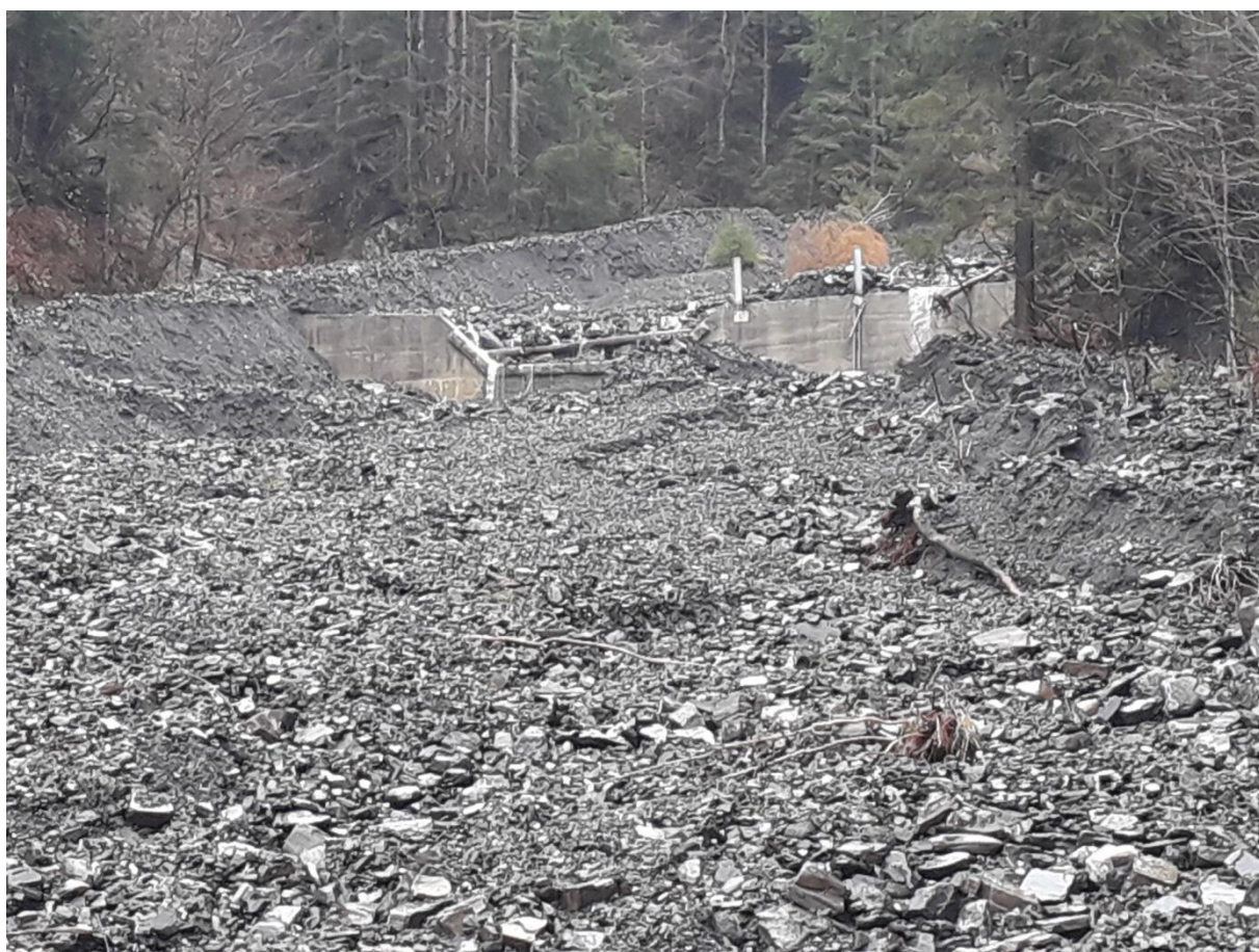
Confronto tra la situazione del sistema di briglie nel 2009 e la situazione attuale.
