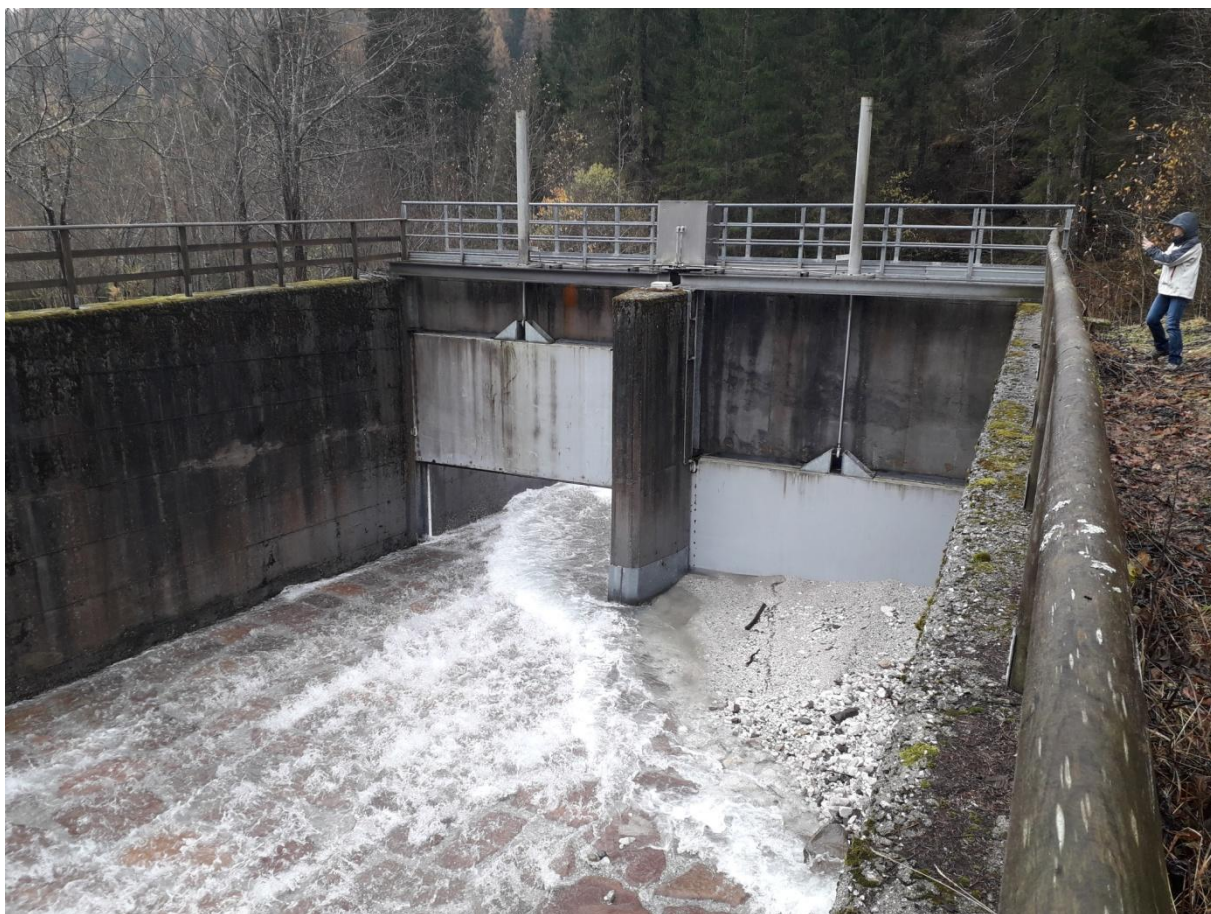
Panoramica del sistema paratie-bypass e particolare dello stato attuale delle paratie.
