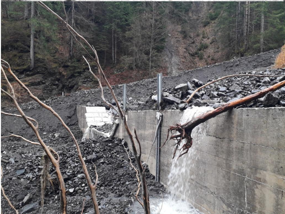
Particolari dello stato della briglia e delle condizioni dei sensori di allarme.
